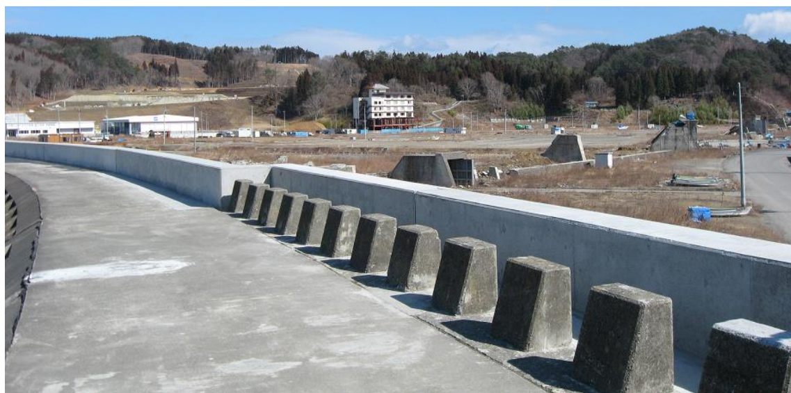
写真1 宮古市田老の被災した防潮堤 撮影：植田剛史(2015年3月2日)。
